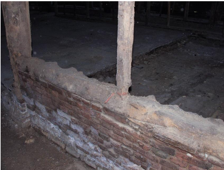
90. Oude potstalmuur met door varkens aangevreten muurplaat.
