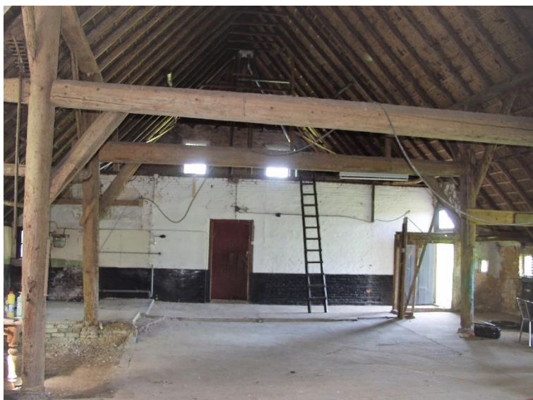
93. Deel met pompstraat en brandmuur.
