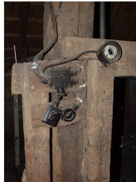
112. Nog zo'n moeilijk op waarde te beoordelen fenomeen: historische elektra, zoals hier op de hoek van de koestal.
