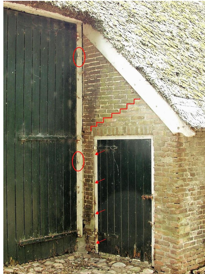
31. Omcirkeld: extra duimen voor een halve baanderdeur; de rode pijltjes wijzen op een slordig afgewerkte dagkant, die een later gemaakte opening verraadt; de rode lijn geeft de bovengrens van het vernieuwde stuk gevel aan.
