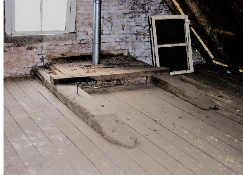
103. Sloffen voormalige schoorsteen.
