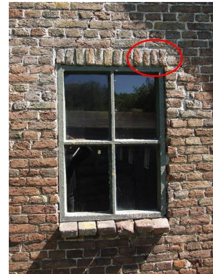
41. Rood: afwijkende stenen rollaag.
